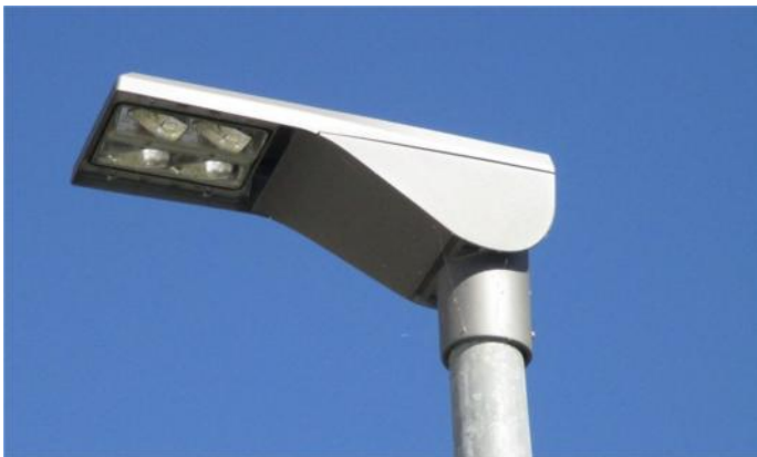
Künftige Leuchten in der Hartmannstraße
